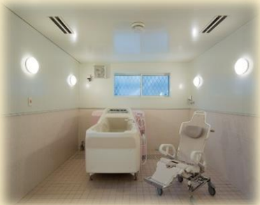
(左上) アンダンテの浴室。一般浴はもちろん、機械浴もとっても気持ち良さそうです!
